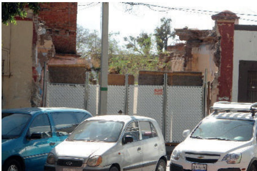
Figura 5. Inmueble ubicado en Río de la Loza Sur No. 26, Centro, uso actual: pérdida del inmueble, quedan algunos vestigios de muros al interior, 80% del inmueble fue demolido.
